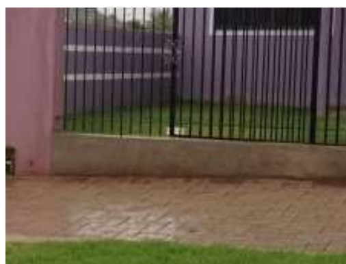
Fossa Séptica próxima da cerca da residência
