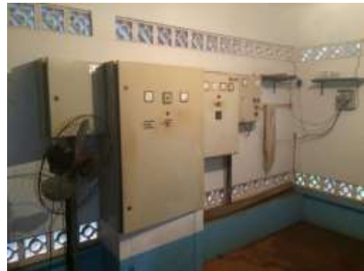
Quadro de comando
