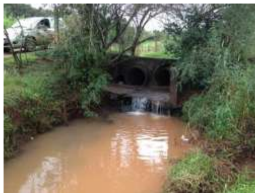
Tubulações da microdrenagem
