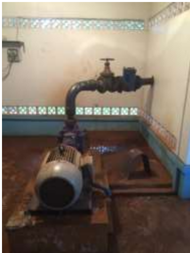
Recalque para Sede
