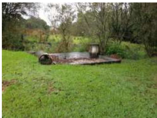
Caixa de drenagem no terreno da captação do Km 10
