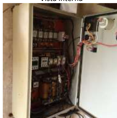
Quadro de comando
