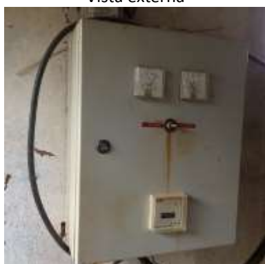
Quadro de comando
