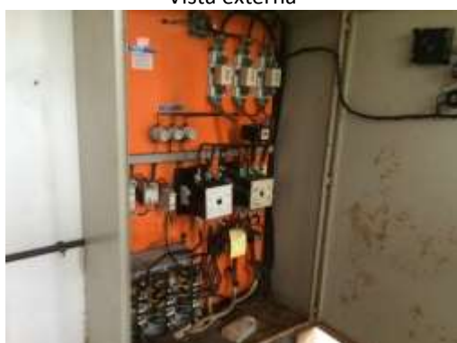
Quadro de comando
