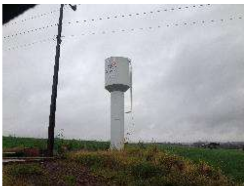
Figura 41 - Reservatório do Abastecedouro Comunitário.
