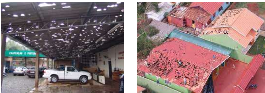
Figura 64 - Estragos provocados por chuva com granizo em Pato Bragado.
