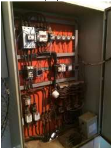
Quadro de comando
