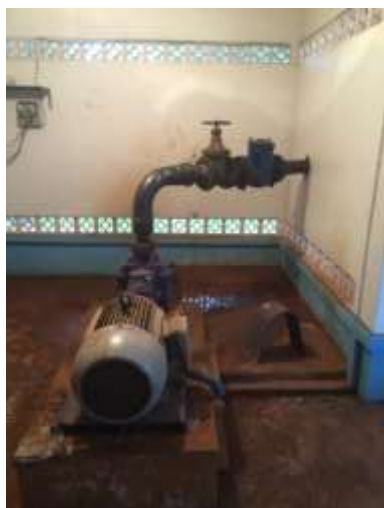
Recalque para Sede
