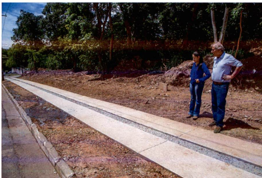
Figura 3: Calçada em concreto desempenada, com espaço disponível para instalação do paver tátil direcional e alerta.
