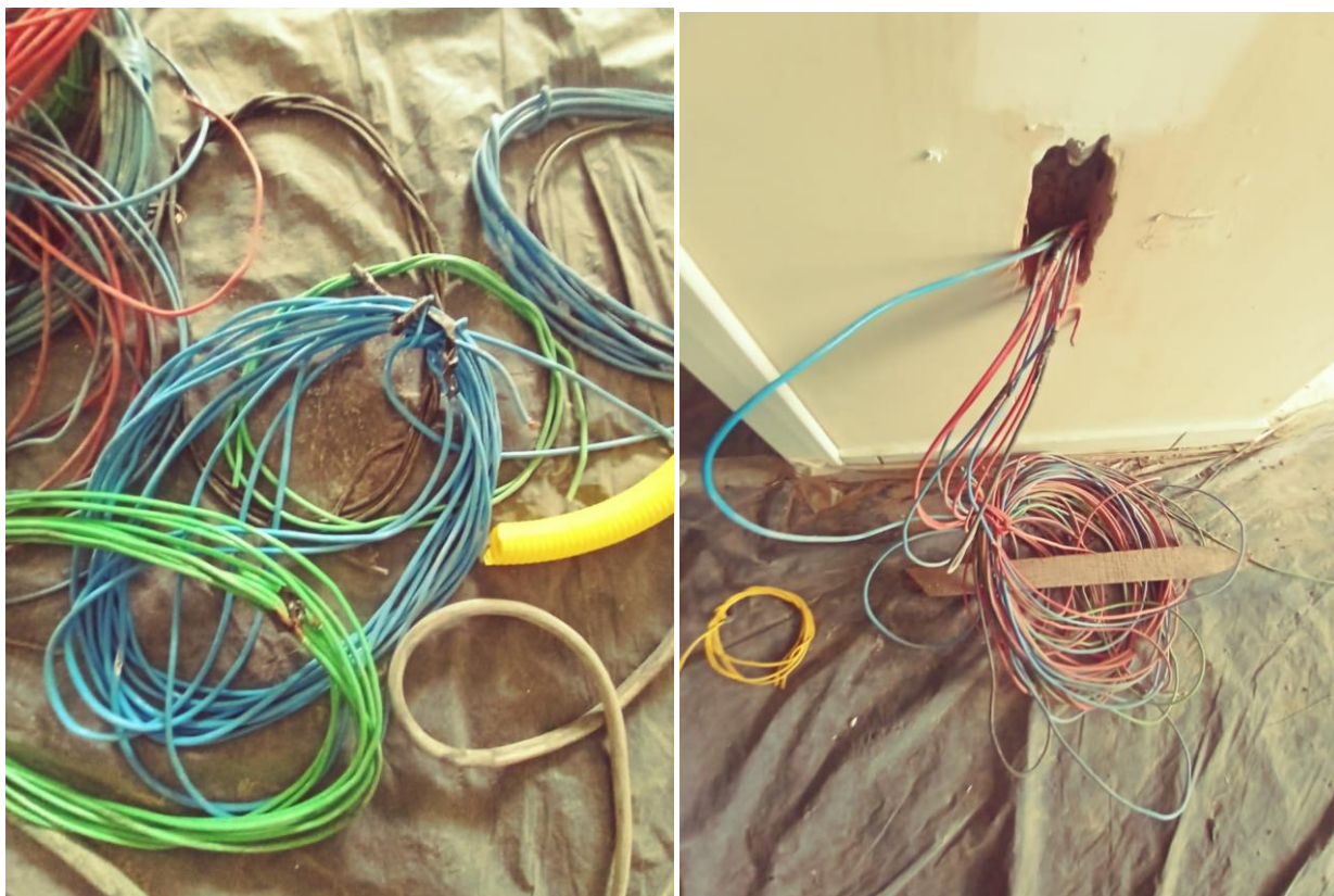
Foto 1 e 2: Excesso de emendas prejudicam a vida útil dos circuitos
